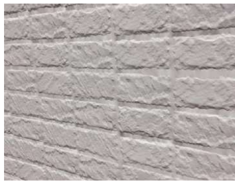
目地部分施工の悪い例
